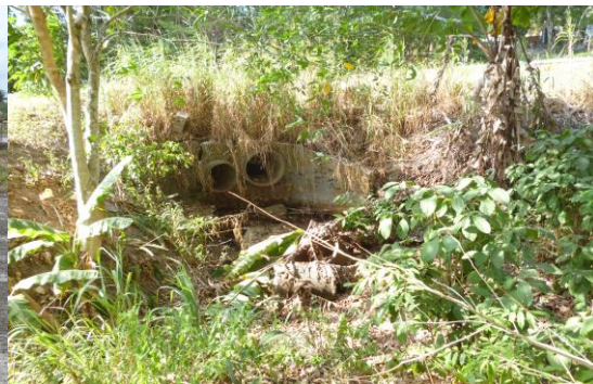
Figura 3. Lançamento de esgotos em igarapés
